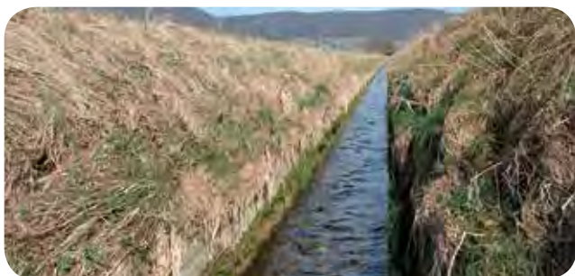
Vor der Aufwertung: Harte Verbauungen aus Beton sind für kleinere Wildtiere unpassierbar.
