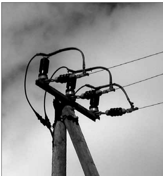
Bilder links: Flügel eines durch Stromschlag getöteten Uhus; gefährlicher Mittelspannungsmasten. Bilder rechts: Um den Stromschlag zu verhindern, werden die stromführenden Elemente näher als 60 cm zum Sitzplatz isoliert.
