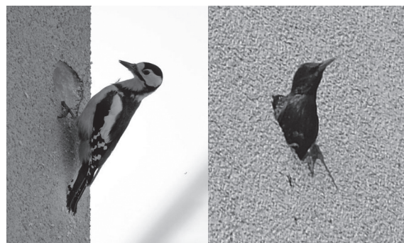
Fig. 1: Picchio rosso maggiore con foro su una facciata con isolamento esterno (R. Oeschger).
