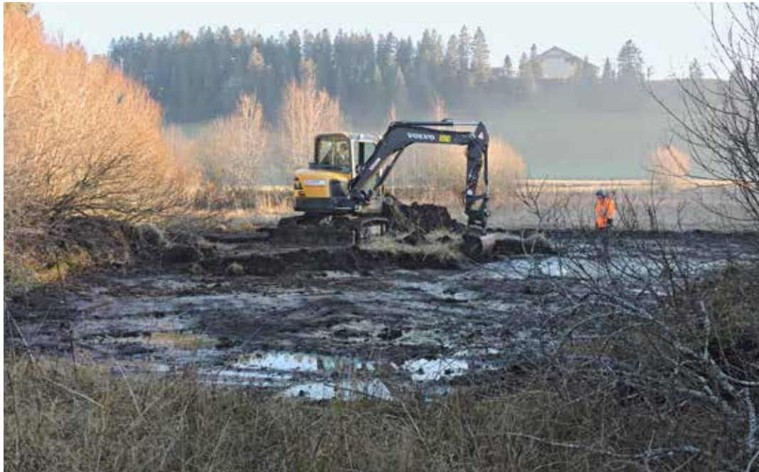
Maschineneinsatz für die Natur: Ein Bagger erstellt kleine Dämme und gräbt Teiche, um das trocken gefallene Moor wieder zu vernässen (Foto: Yvan Matthey).
