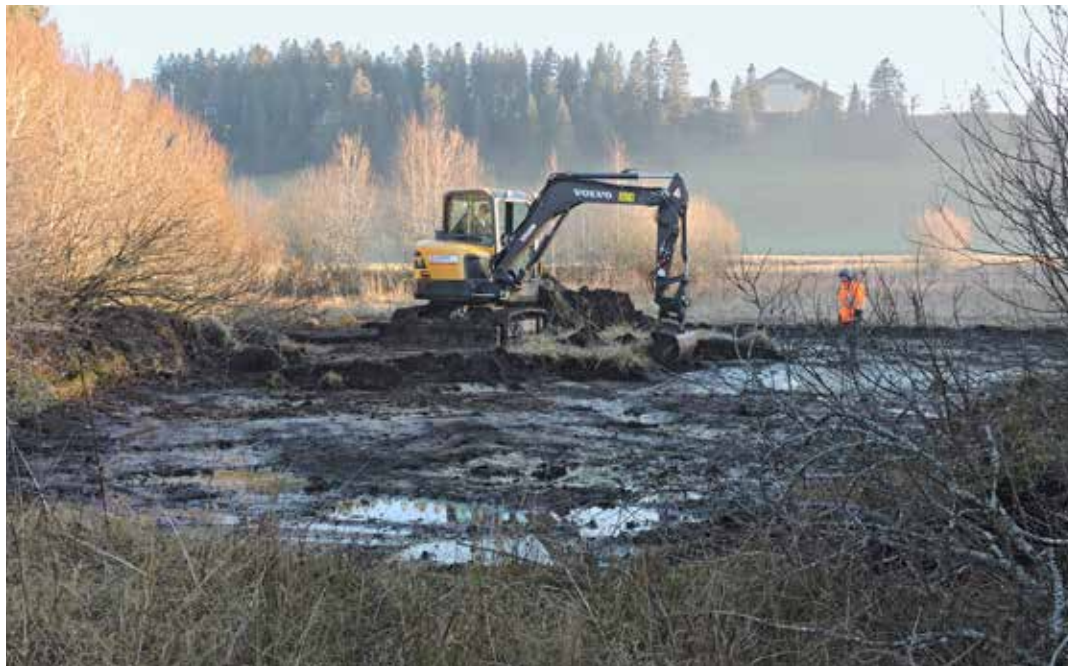
De petites digues et des étangs sont aménagés à l'aide d'une pelle mécanique afin de remettre en eau le marais asséché (photo: Yvan Matthey).
