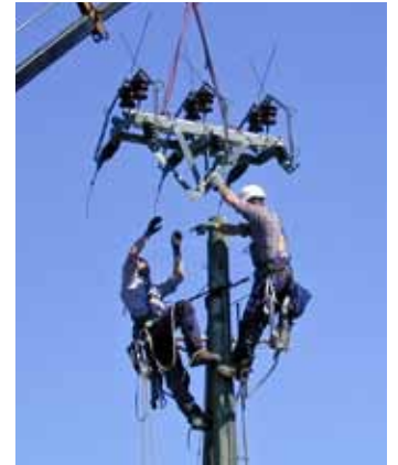
Ein besonders gefährlicher Masttrenner wurde von den Engadiner Kraftwerken bei Crusch durch einen einfachen Endmast ersetzt. Hier fand wenige Monate vorher ein Uhu den Stromtod (Foto: Men Janett).
