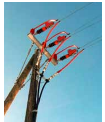
Gefährlicher Endmasten nach der Sanierung durch die Repower bei Celerrina. Hier erlitt ein Uhu im Herbst 2011 den Stromtod. Dessen Revier verwaiste in der Folge (Foto: Giacom Krüger).
