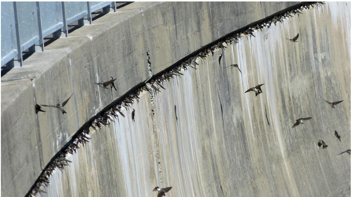
Abb. 14. Ansammlung von hunderten Mehlschwalben an der Staumauer vom Lago del Sambuco 1462 m ü.M. im Tessin (Foto von Werner Studer, 14. August 2013).
