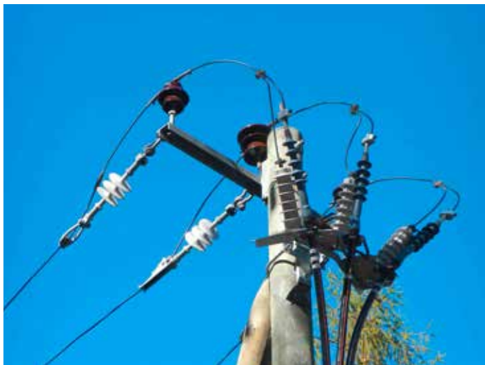
Dieser Mittelspannungsmasten ist nicht isoliert. Ab einer gewissen Grösse kann ein Vogel mit gespreizten Flügeln gleichzeitig zwei stromführende Elemente berühren und so einen tödlichen Stromschlag erleiden (Foto: David Berthold).
