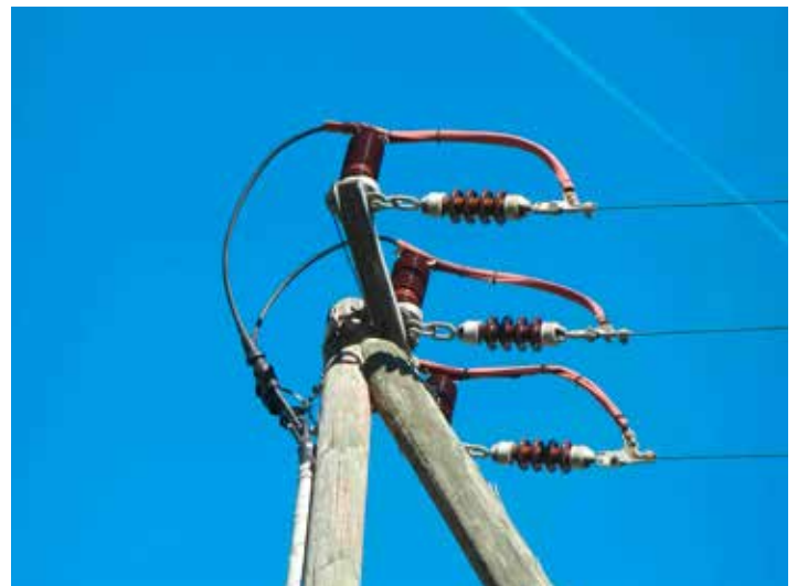
Dieser Mittelspannungsmasten wurde mit roten Isolatoren vogelsicher gemacht. Hier droht kein tödlicher Stromschlag mehr (Foto: David Berthold).
