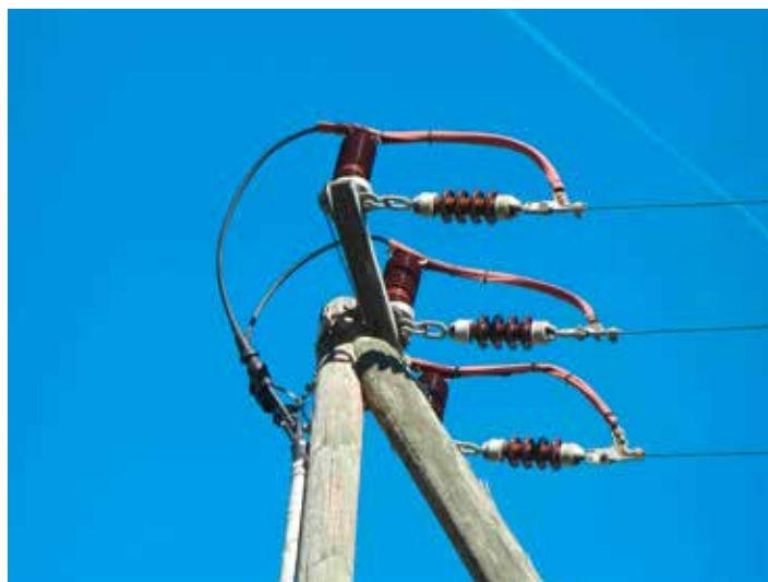
Questo pilone di una linea a media tensione è stato reso sicuro per gli uccelli tramite l'isolazione dei conduttori (in rosso). Qui non esiste più alcun pericolo di una mortale elettrocuzione (foto: D. Berthold).
