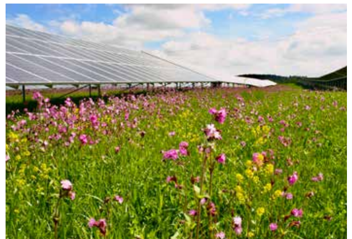
Photovoltaik-Freiflächenanlagen mit extensiver Wiese. Im Idealfall eröffnet sich eine Chance für die Biodiversität (Foto: Helmut Wartner).
