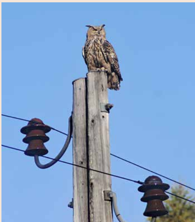
Bei den Mittelspannungsmasten gibt es gefährliche und weniger gefährliche Typen. Ausschlaggebend ist, ob ein sitzender Uhu mit geöffneten Flügeln stromführende Elemente berührt und dadurch einen Kurz- bzw. Erdschluss auslösen kann. Holzmasten gehören zu den weniger gefährlichen Typen (Foto: David Jenny und Werner Fischer).
