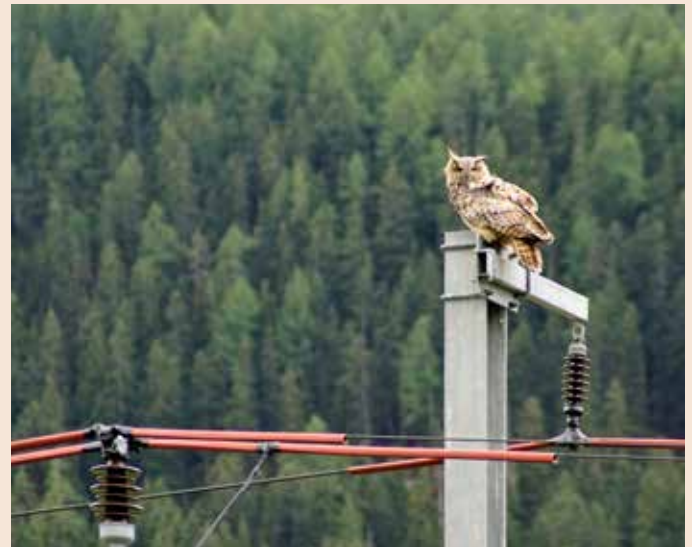
Fahrleitungsmasten der Bahn werden von Uhus gerne als Sitzwarten genutzt. Im Engadin wurden mittlerweile 250 Masten von der Rhätischen Bahn durch Isolation gegen Stromschlag saniert (Foto: David Jenny und Werner Fischer).
