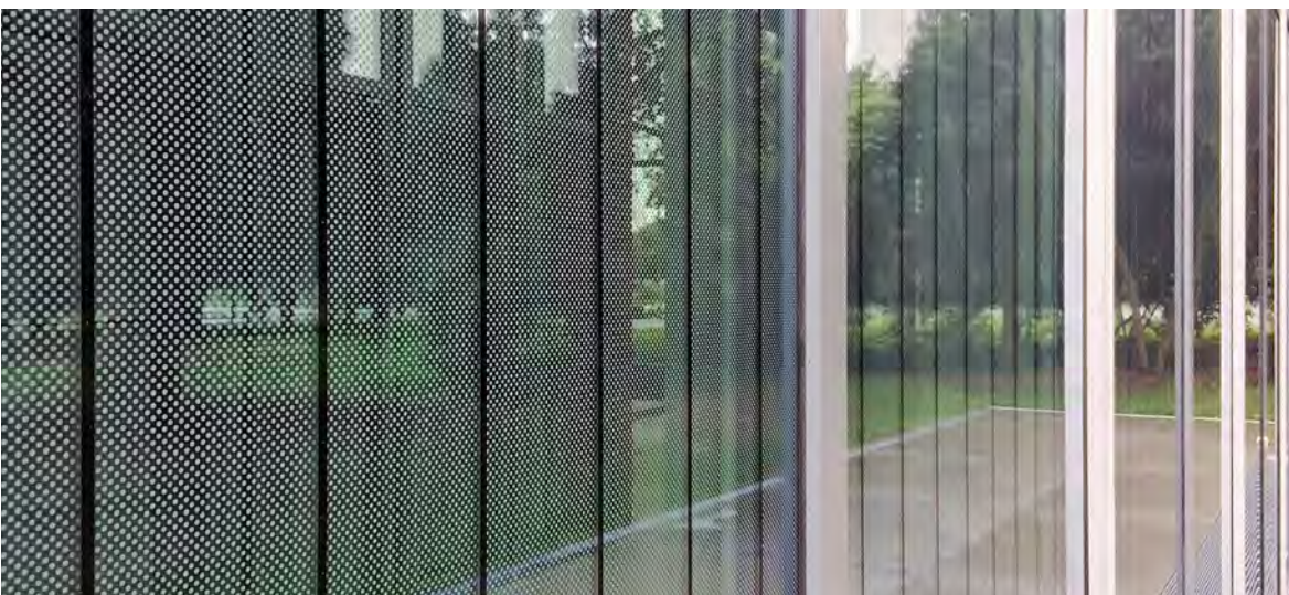
Museo Bauhaus a Dessau (Germania): nonostante un grado di copertura del 30 %, il fine reticolo a punti non è adatto alla protezione degli uccelli a causa della sua bassa riconoscibilità. La facciata è stata quindi dotata in un secondo tempo di strisce nere.
